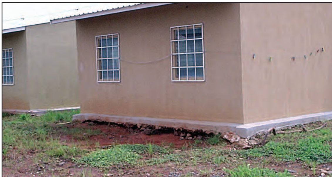
Las inundaciones de septiembre y octubre de 2004 produjeron inmensos daños en urbanizaciones construidas en las llanuras del sudeste de la región. Prados del Este, la más afectada de ellas, fue demolida con posterioridad.
