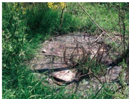
Figura 30. Cámara de inspección del sistema de tratamiento del MEVIR I totalmente desbordada por las aguas servidas
