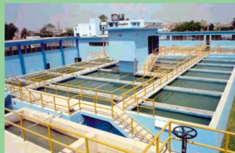
Planta de tratamiento de agua de EPSEL
