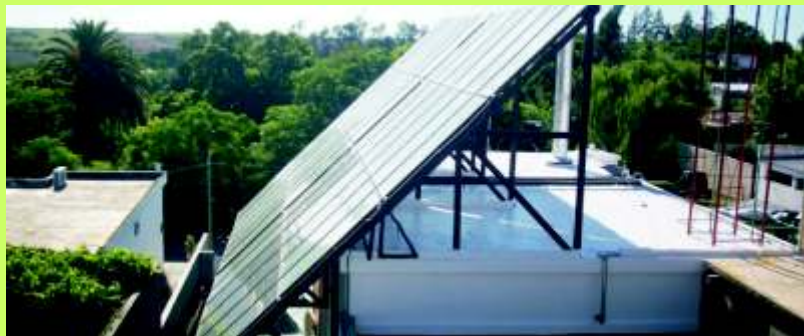
Foto 5. Calentamiento de agua: colectores para captar energía solar. Autor: CAMEC.
