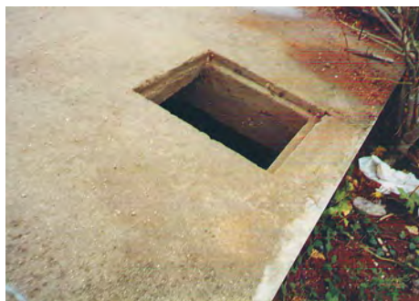
Fotografia 2.41 – Detalhe da falta da tampa da fossa séptica do bairro de Nossa Senhora da Saúde
