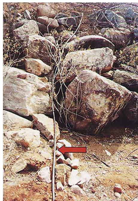
Fotografia 2.36 – Canalização (indicada pela seta em vermelho) localizada à jusante da segunda lagoa de estabilização, captando sua água para irrigação de determinadas culturas
