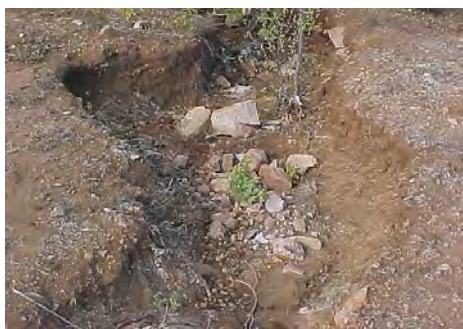
Fotografia 2.38 – Voçoroca na margem esquerda da lagoa de estabilização primária
