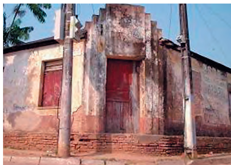
Fotografia 14 – Prédio histórico em degradação
