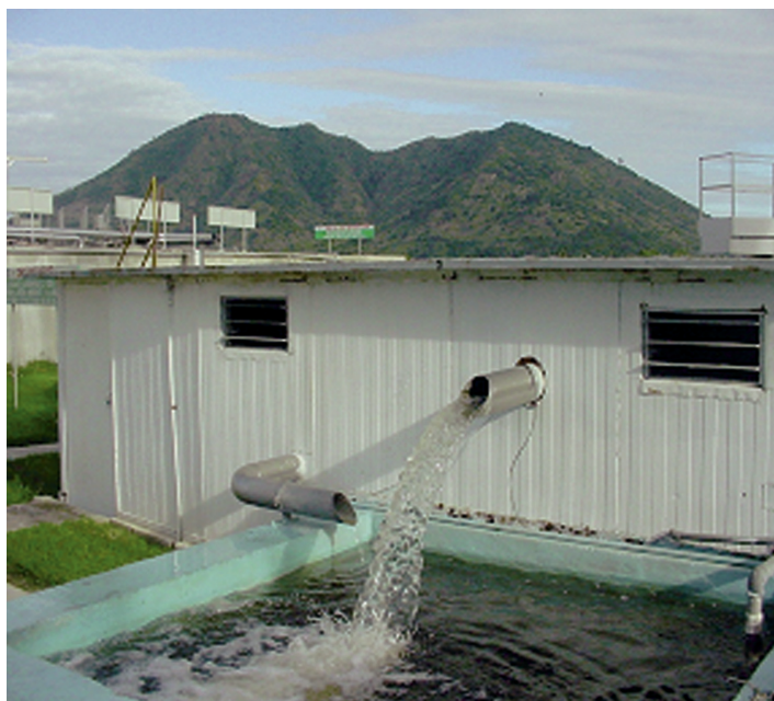
Sistema de tratamiento de aguas residuales (Dirección de Comunicaciones, MARN)
