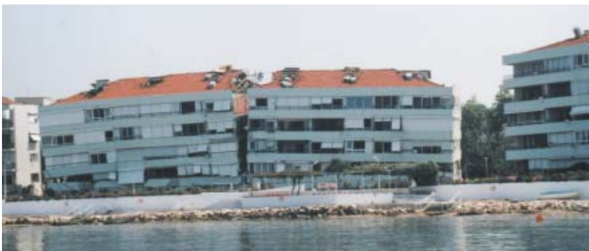
Immeuble d'habitation scindé en deux par le séisme de 1999 à Izmit (Turquie).
