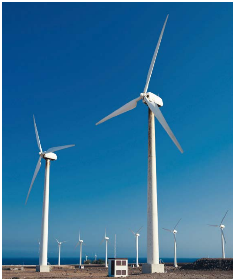
可再生能源将在向低碳经济转型中起到至关重要作用; 仅风能一项在 2010 年欧洲的新装发电装置中占 41%。© Mlenny Photography/iStock
