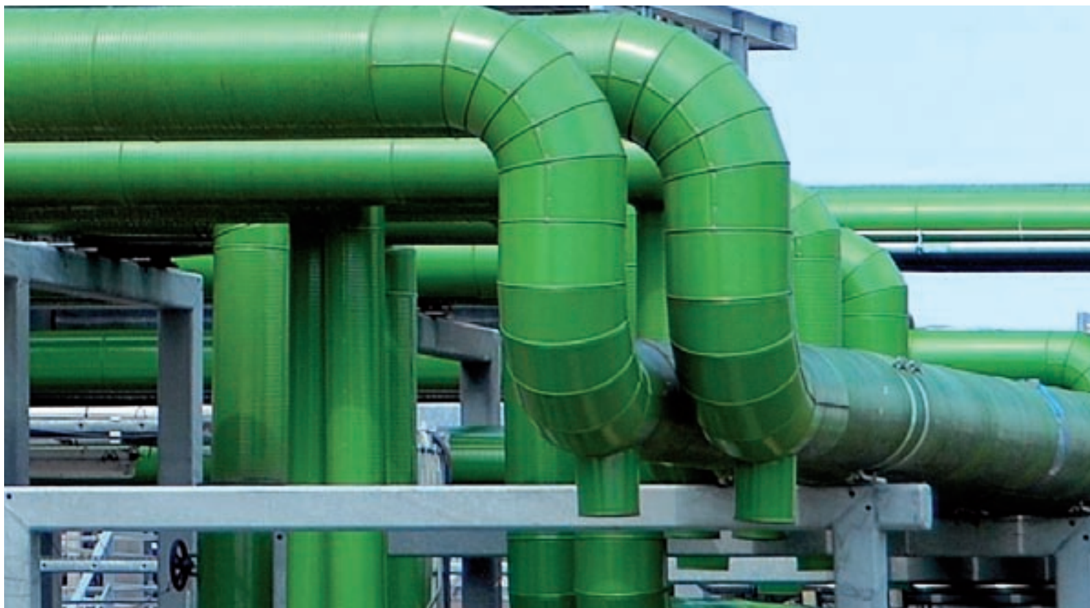
Canalisation de vapeur d'une centrale électrique et d'une installation de valorisation de l'éthanol en vue de sa réutilisation, sur la zone de symbiose industrielle de Kalundborg, au Danemark. Source : Ove Andersen
