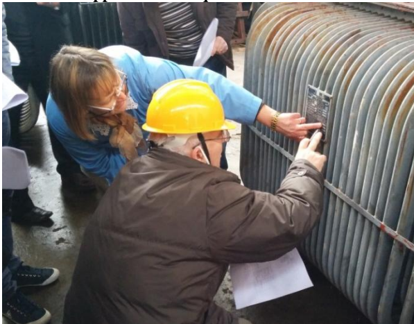
Photo 9 : Enregistrement de toutes les données des appareils électriques échantillonnés
