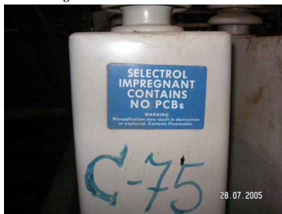
Photo 12 : Vignette informative sur un condensateur
