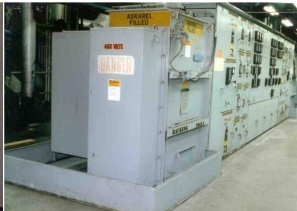
Photo 39 : Système de rétention en acier
