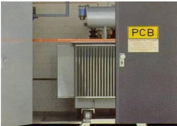
Photo 38 : Étiquetage de la porte d'une salle de transformateurs
