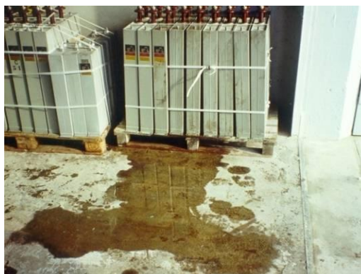
Photo 85 : Mauvais exemple II (absence de bac récepteurs)
