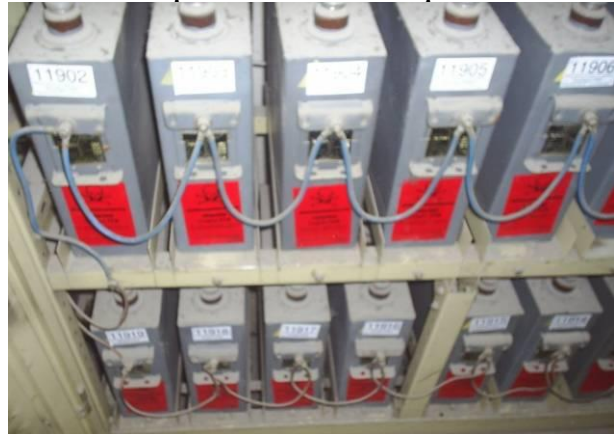
Photo 36 : Exemple de condensateurs étiquetés
