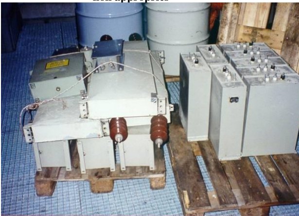
Photo 57 : Exemple de conditionnement et d'entreposage non appropriés
