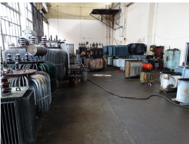
Photo 40 : Transformateur en zone de maintenance
