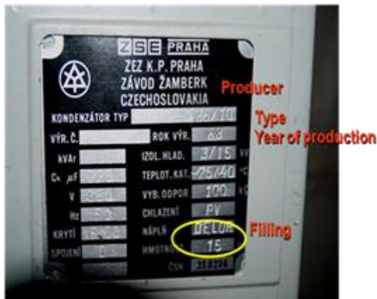
Photo 11 : Identification du fluide d'un condensateur
