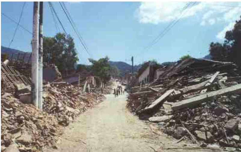
Destroyed adobe houses, El Salvador (López, M.)
