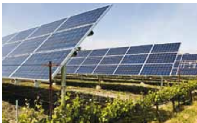
Des panneaux solaires pour faire fonctionner les installations mécaniques dans un vignoble de Californie
