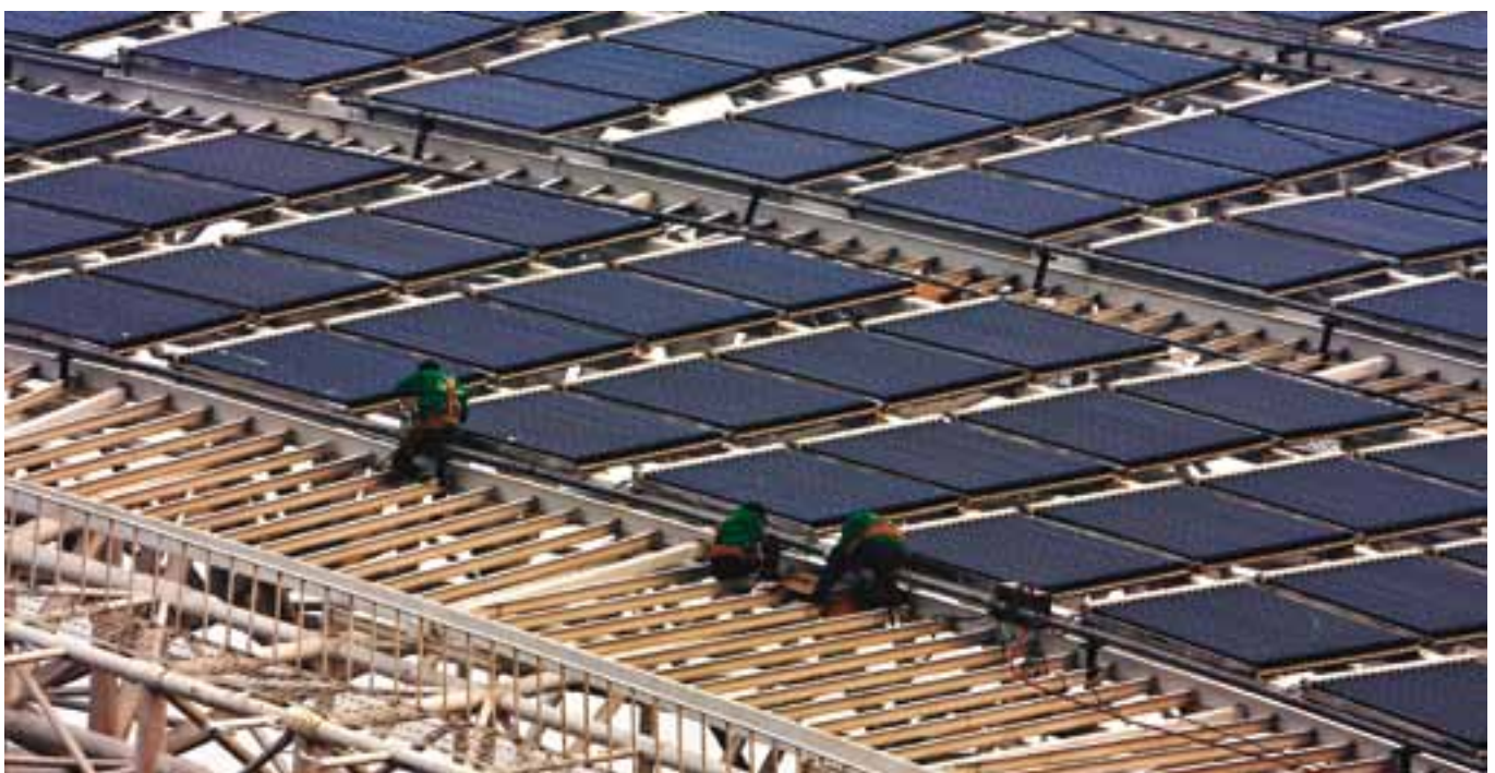
Capteurs solaires sur les toits d'une entreprise en Chine
