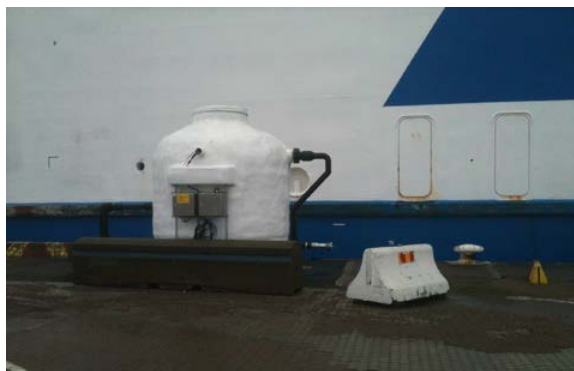
Collecte d'eaux usées dans le port de Trelleborg (Suède) (Crédits photographiques : Clean Baltic Sea Shipping)
