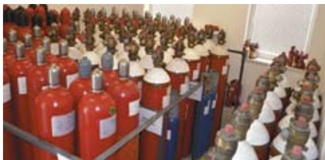
Czech halon bank in Cheb (halon cylinders) Чешский банк галонов в Чехе (баллоны с галоном)
