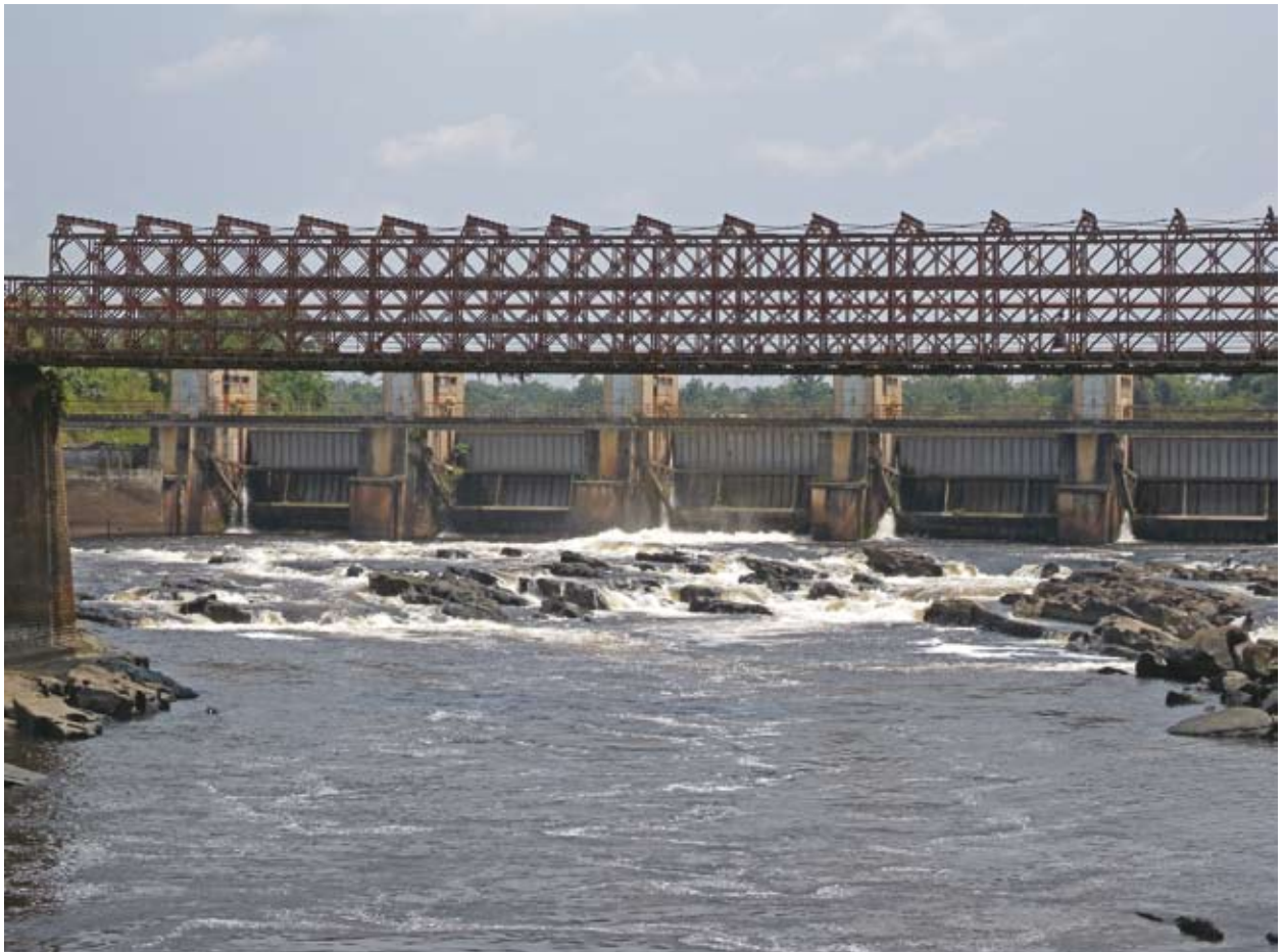
L'usine hydro-électrique de Tshopo à Kisangani, dans la province Orientale, est l'un des nombreux dispositifs par dérivation à empreinte écologique réduite existant en RDC
