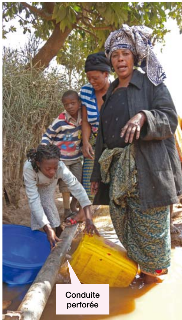
Habitants de la cité Musonoie, à Kolwezi, faisant la queue pour récupérer l'eau fuyant des canalisations endommagées (province de Katanga)
