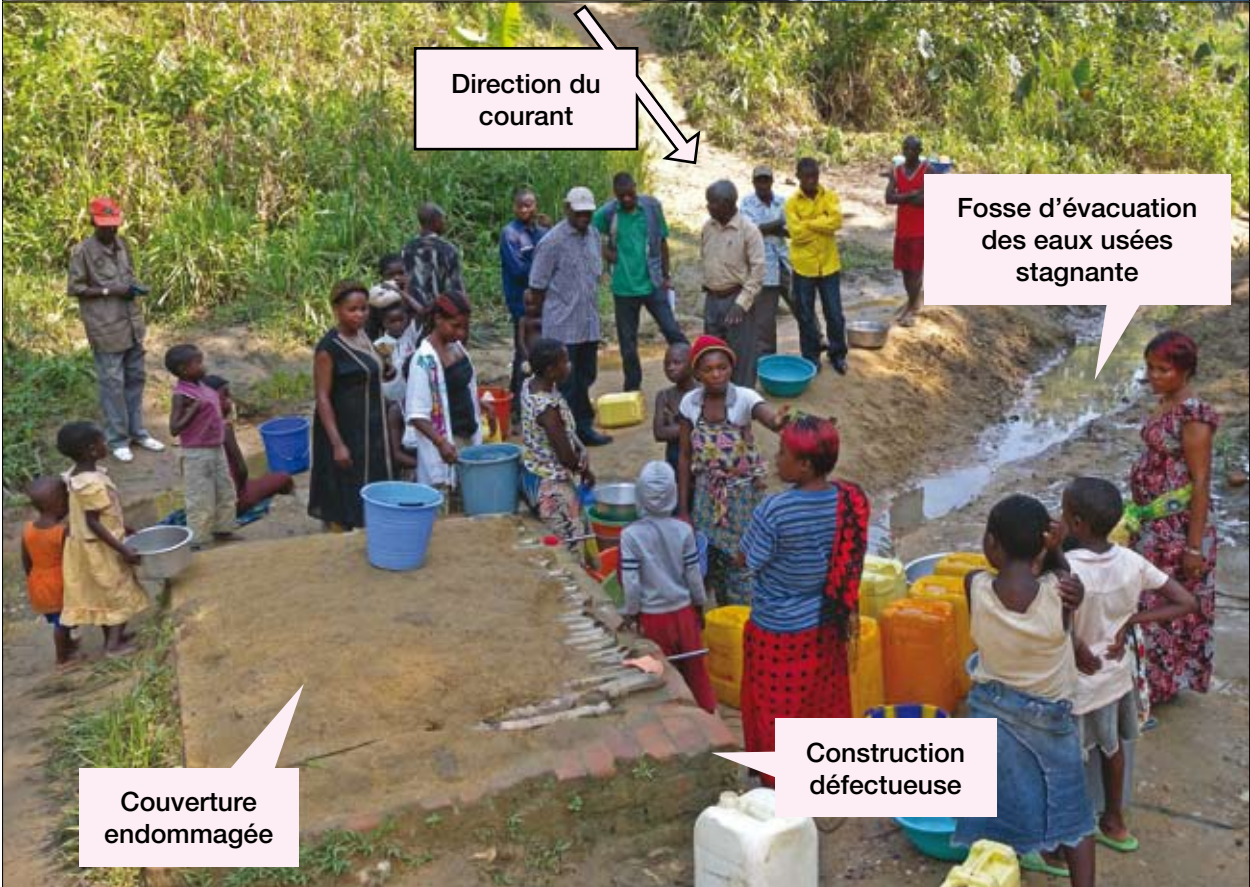
A Kalima, province de Maniema, la source aménagée de Baganda présente plusieurs traits caractéristiques d'une mauvaise construction et d'un manque d'entretien : débit réduit, couverture endommagée, sédiments entassés bouchant l'évacuation, absence de barrière, présence de sentiers directement en amont augmentant les risques d'érosion et de contamination
