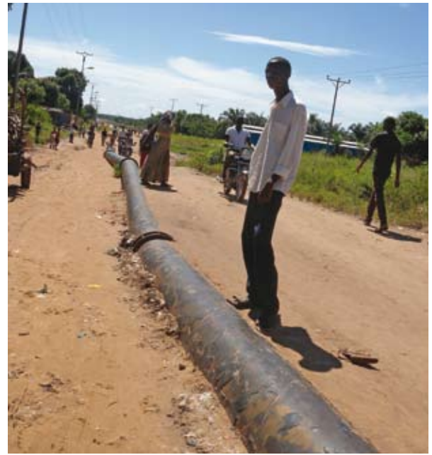
La structure du conduit principale de la REGIDESO à Mbuji-Mayi est exposée et vulnérable. En février 2010, une panne catastrophique a entraîné la perte soudaine de millions de litres d'eau et a endommagé les propriétés avoisinantes. La distribution d'eau a dû être arrêtée pendant plusieurs semaines dans cette ville de plus d'un million d'habitants (ci-dessus et ci-dessous)
